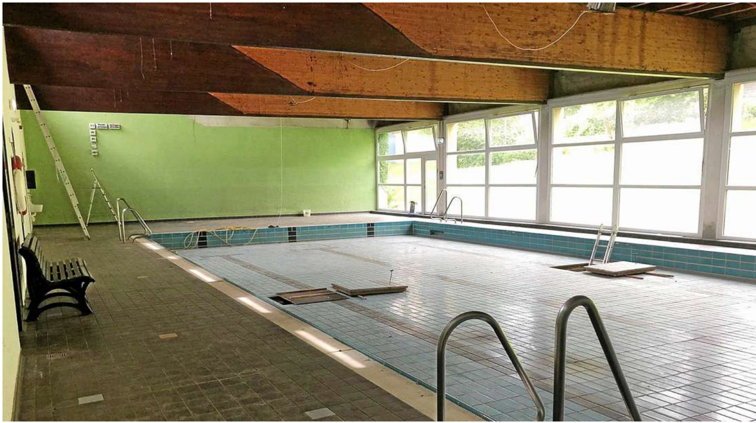
Seit März 2020 ist das Lehrschwimmbecken (LSB) Herdringen geschlossen. Nun soll die Sanierung kommen. PRIVAT
